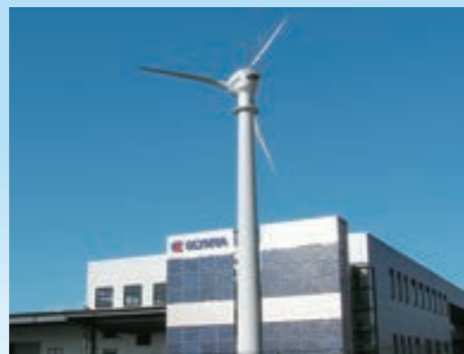
群馬工場の風力発電設備
